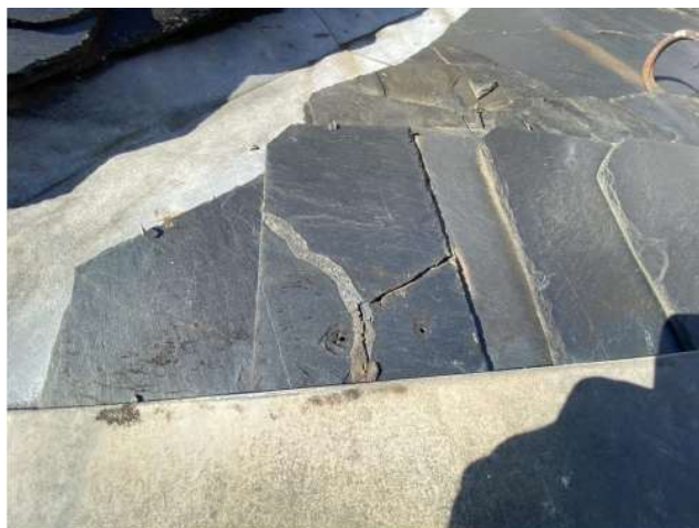
Rückwärtiger Dachbereich, Detail Fensteranschluss, gebrochene Schieferplatten
