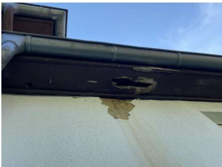
Detail Traufgesims, Schädigung infolge undichtigkeit
