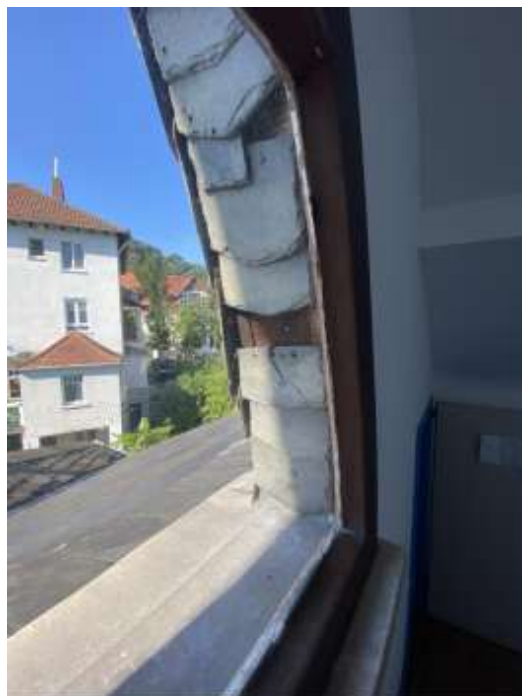
Detail Fensterlaibung, Fehlstellen in der Verschieferung
